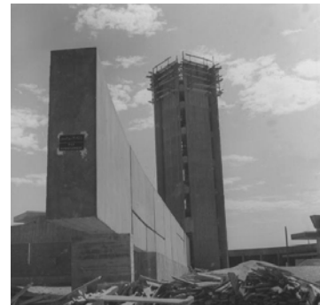
Photo 6: Caserne des sapeurs pompiers en chantier - JF Zevaco (Photo A. El Hariri – Docomomo Maroc)
